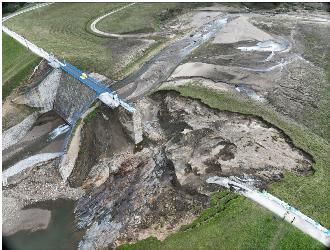
Uszkodzona część ziemna zapory. Odsłonięte lite skały, na których posadowiono obiekt.
