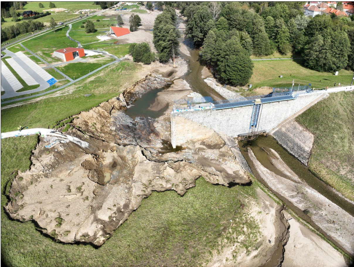
Zniszczona zapora na Morawce w Stroniu Śląskim. Widok od strony wody górnej.
