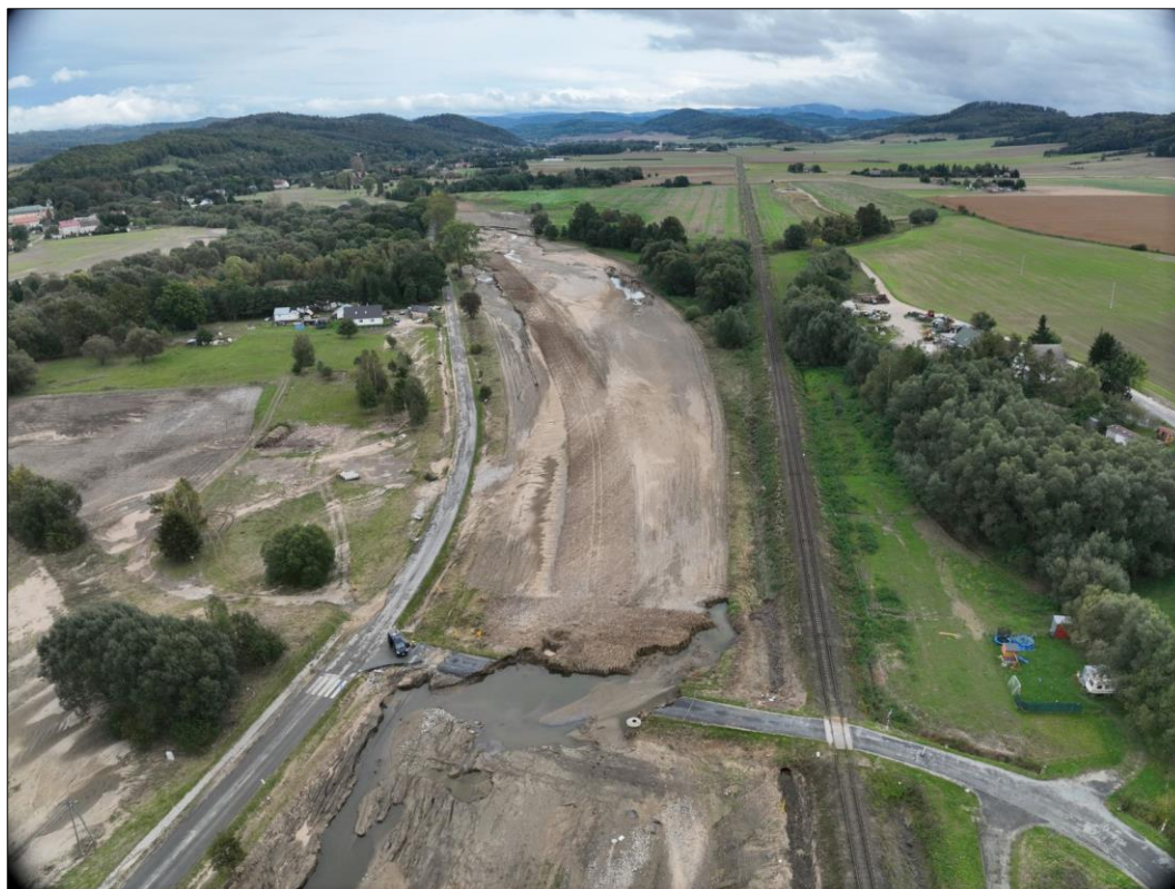
Uszkodzona droga w Krosnowicach. Koryto Białej Łądeckiej znajduje się około 250 m na lewo od drogi.
