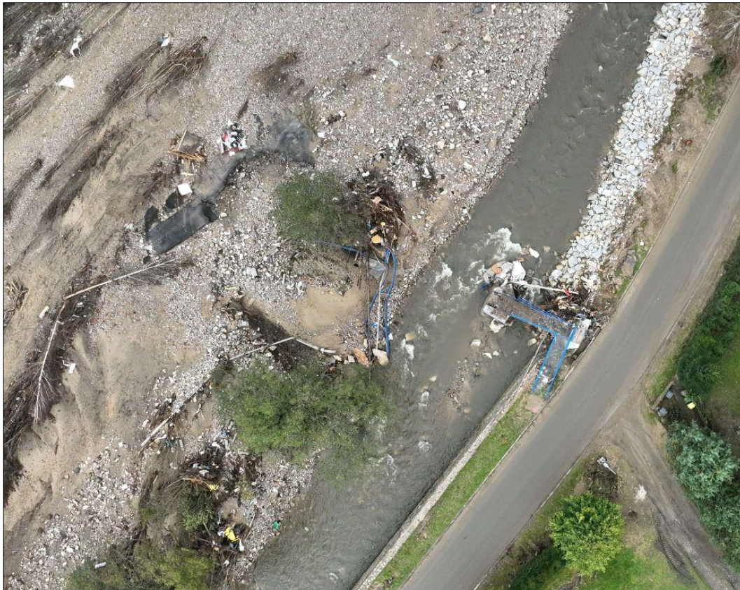
Zniszczony most w Łądku-Zdroju.
